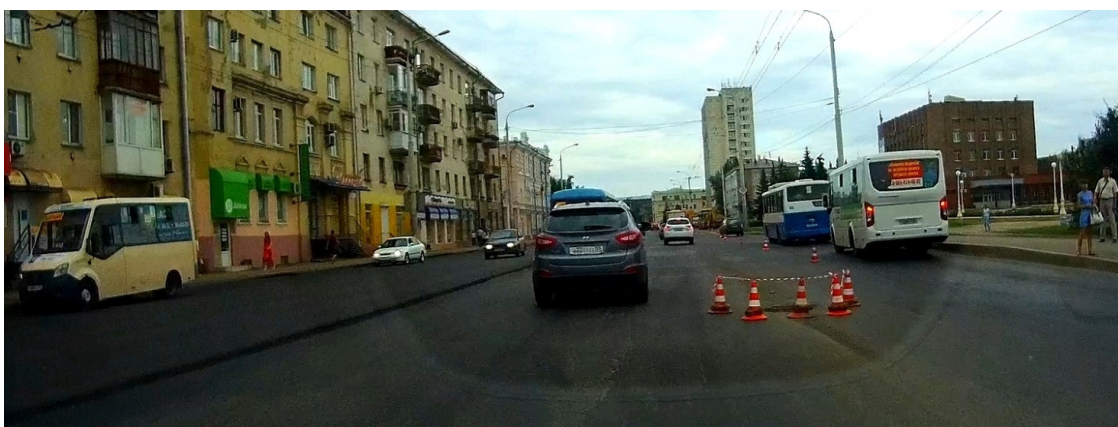
Дефект проезжей части, обозначенный дорожным конусом
