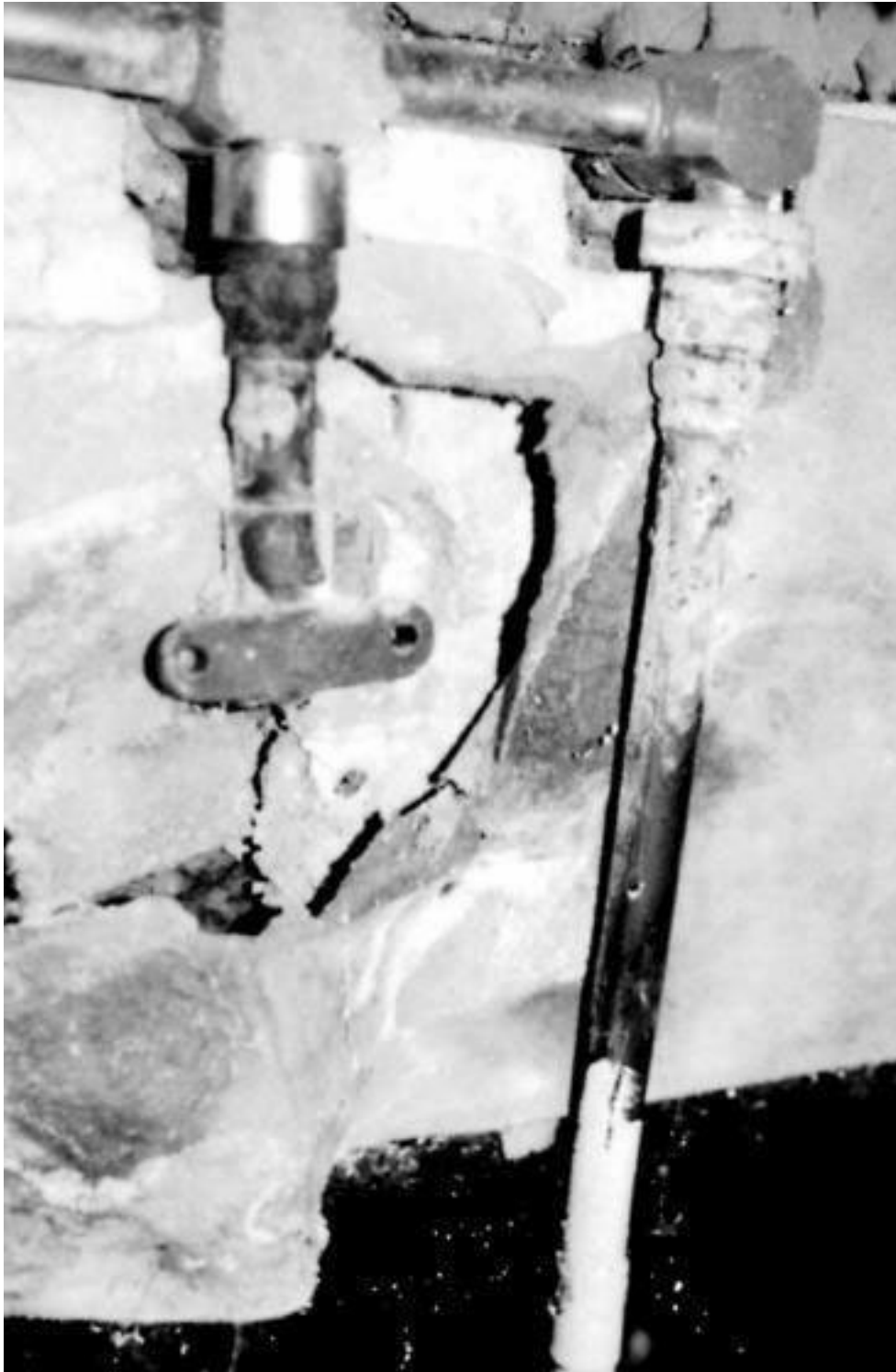
Рис. 2.5. Минеральные отложения на стыках труб и отваливающиеся куски штукатурки – последствия просачивания воды
