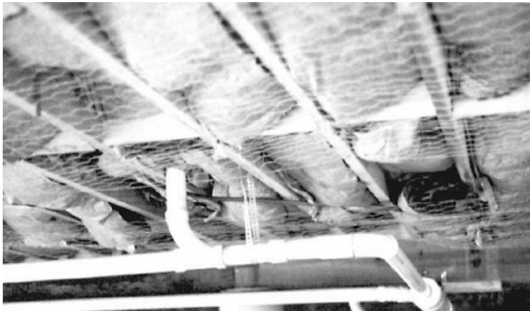
Рис. 1.10. Сантехническая лента, поддерживающая отводящую трубу с нужным уклоном
